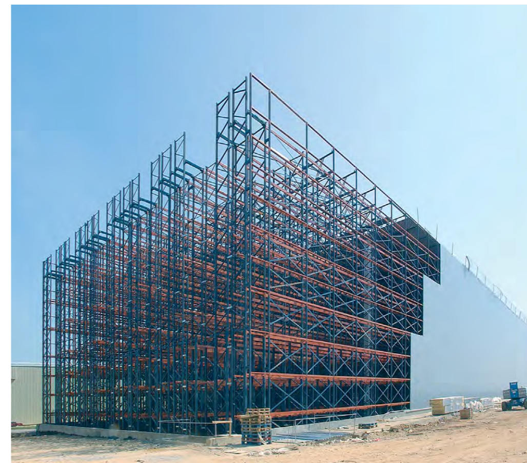
A képen látható ÖNHORDÓ RAKTÁR méretei valóban lenyűgözőek. A rendszer előnyeiről azonban nem kell lemondani annak sem, aki jóval kisebb raktáracsarnokot építtetne, hiszen kisebb méretben is tervezhető. A megoldás lényege, hogy az állványrendszer tartja az épület szerkezetét is.
